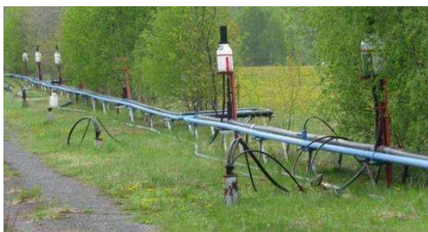
Sběrné trubky kyselých vod z podzemního loužení
